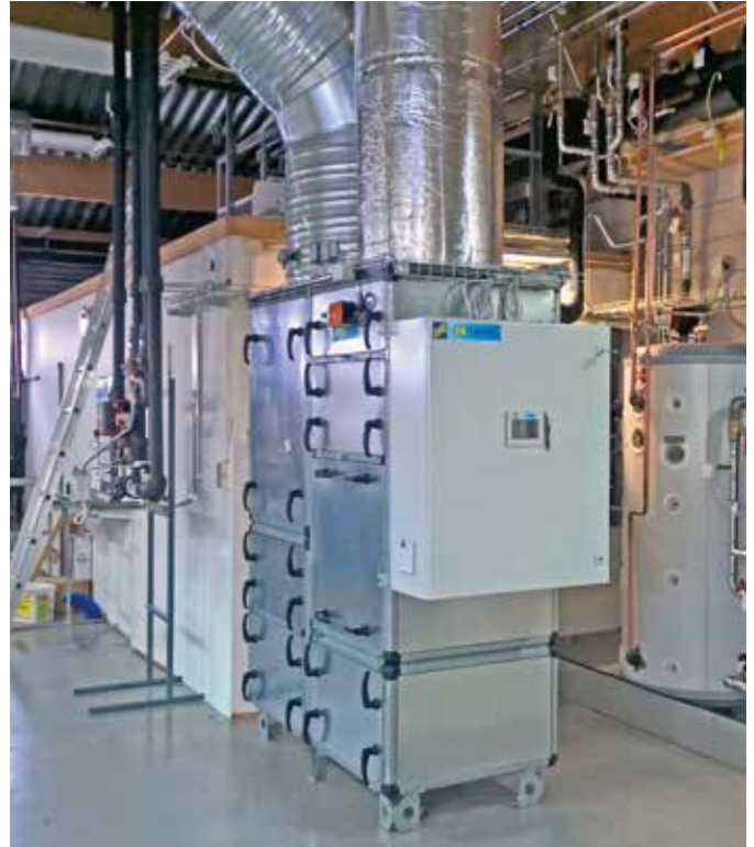
Hallin uusi sisäsovitteinen pystymallinen RETCARE IN S -tuloilmakone on mitoitettu 1000 litralle sekunnissa. Silti kone mahtuu neliometrin kokoiselle alueelle. Tehdasympäristössä kone ei tarvitse omaa konehuonetta. Eristetty raitisilmakanava tulee koneen päälle ja sitä seuraavat sulkupelti, suodatin, lämmityspatteri, puhallin ja äänenvaimennin. Tuloilmakoneen vasemmalla puolella näkyy LTO-järjestelmän toimilaitepaketti.
