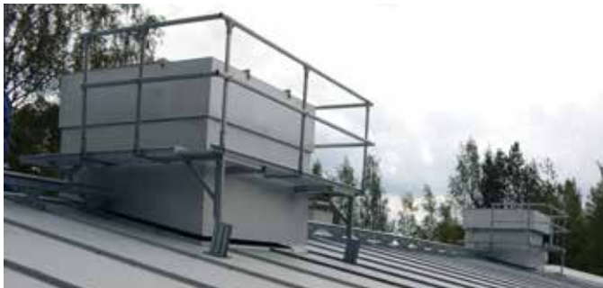
Tuloilman esilämmitys-, LTO-, ja jäädytystoiminnot suoritetaan vesikatolla sijaitsevalla ilmanottokatoksella (oik). Vasemmalla LTO-huippuimuri.
