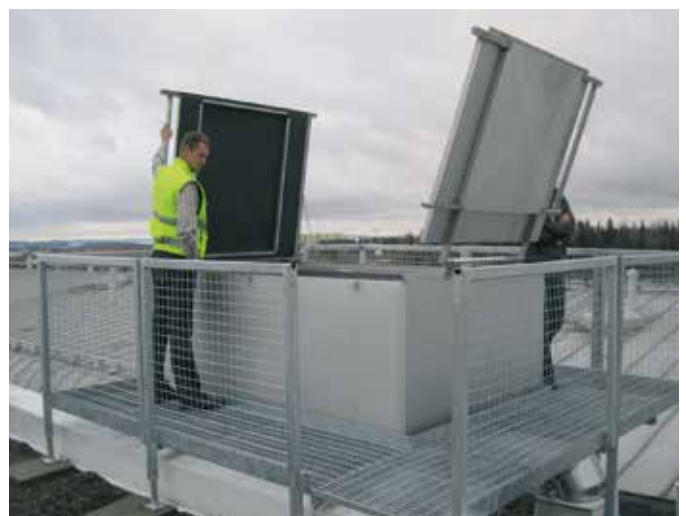
Vanhat ulospuhallushajottajat korvattu ulospuhalluskatoksella (ilmavirta 5 m³/s). Ulospuhalluskatos mahdollisti lämmöntalteenoton neljästä pienestä poistoilmakoneesta yhdellä neulalämmönsiirtimellä.
