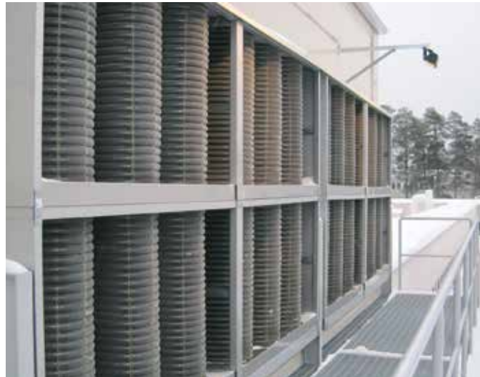
LTO-patteriseinä (tuloilmavirta 26,5 m 3 /s) asennettuna Oulun yliopistollisen sairaalan keskuskeittiön ulkoseinälle. Patteriseinä koostuu neljästä rinnakkaisesta ja kahdesta päällekkäisestä Retermia-runcoon -patterista. Tämä asennustapa vastaa asennusperiaatetta 1.10.
