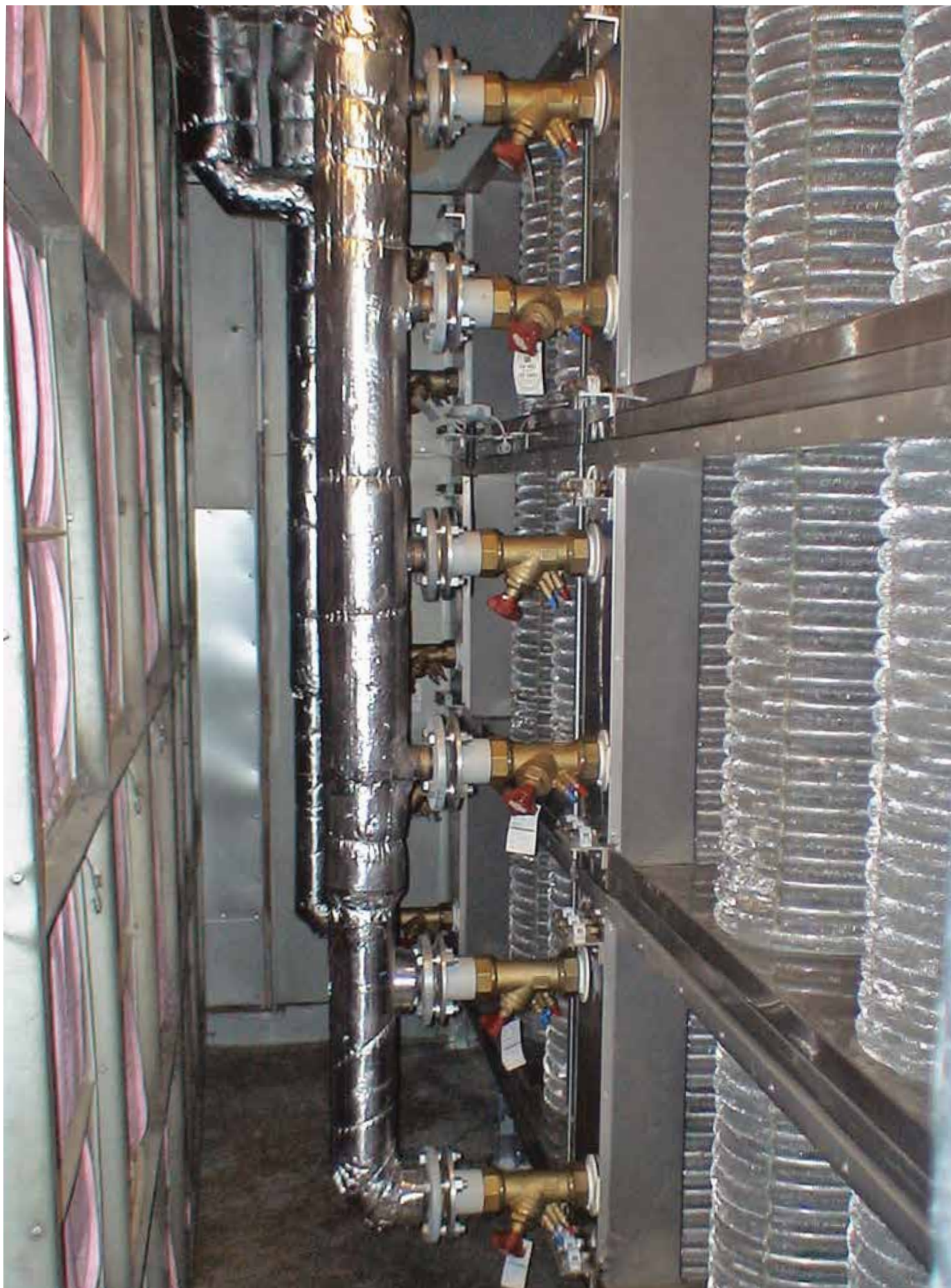
Retermia-runkoon -patteriseinä Arlandan lentokentän tuloilmakammiossa. Kuva on otettu huoltokammioista, joka sijaitsee ilman virtaus suunnassa patteriseinän jälkeen. Suodattimet on sijoitettu neulalämmönsiirtimien jälkeen ilman virtaus suunnassa. Tämä asennustapa vastaa asennusperiaatetta 1.12.
