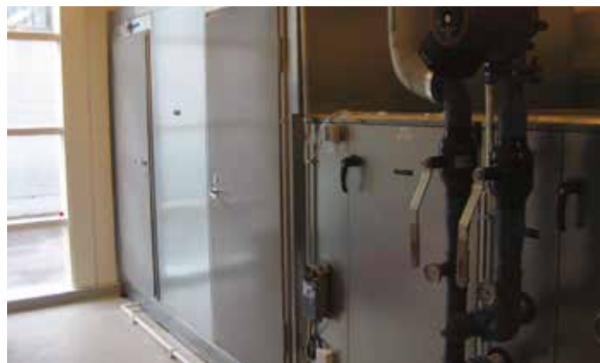
LTO-patteriseinä (tuloilmavirta 7,2 m 3 /s) hitsauspajan ilmanotokammiossa. Patteriseinä koostuu kahdesta päällekkäisestä Retermia-runcoon -patterista. Tämä asennustapa vastaa asennusperiaatetta 1.12.
