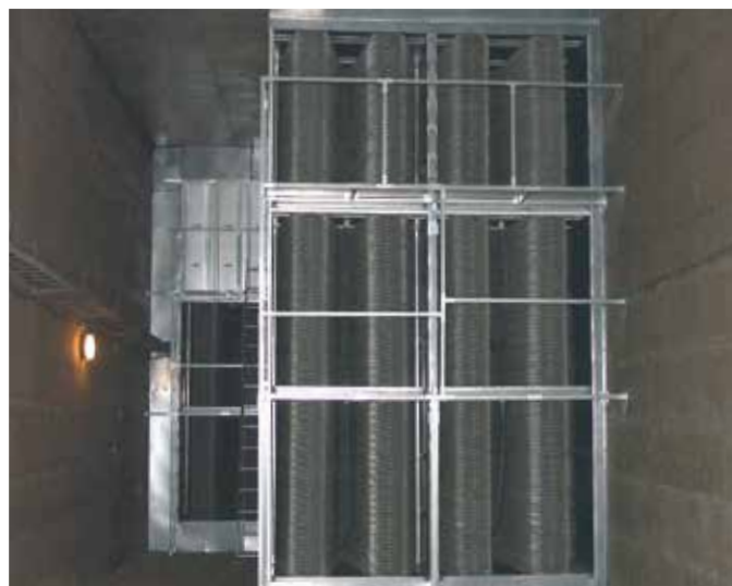
LTO-patteriseinä (tuloilmavirta 120 m 3 /s) asennettuna maanalaiseen kuluun Helsingborgin sairaalassa Ruotsissa. Patteriseinä koostuu neljästä rinnakkaisesta ja kolmesta päällekkäisestä Retermia-runcoon -patterista. Tämä asennustapa vastaa asennusperiaatetta 1.12.
