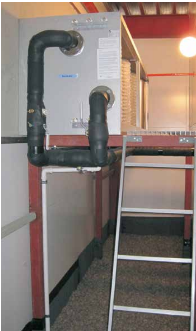
Retermia-runcoon -lämmöntalteenottolaitte (tuloilmavirta 3,0 m 3 /s) lisälmen sairaalan tuloilmakammiossa. Tämä asennustapa vastaa asennusperiaatetta 1.7.
