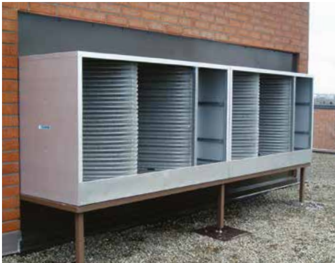
Kaksi rinnakkaista Retermia-runcoon -lämmöntalteenottolaitetta (tuloilmavirta 5,6 m 3 /s) lisälmen terveyskeskuksen ulkoseinällä. Tämä asennustapa vastaa asennusperiaatetta 1.5.
